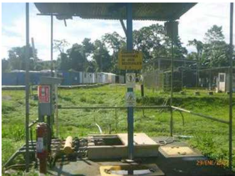
Fotografía 10: Cámara de reunión de aguas residuales en PTARD C4 en CBM (Fuente: PPC)
