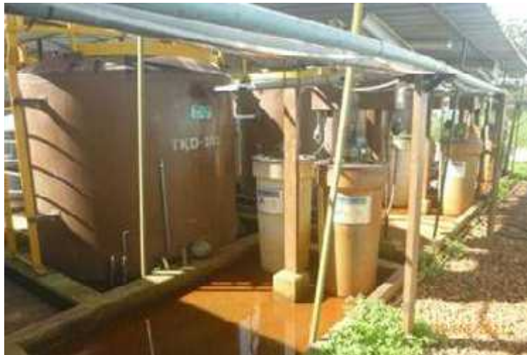
Fotografía 15: Sistema terciario en PTARD C4 en CBM (Fuente: PPC)
