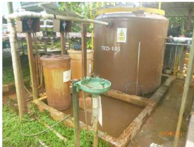
Fotografía 7: Sistema terciario en PTARD C1 en CBM (Fuente: PPC)
