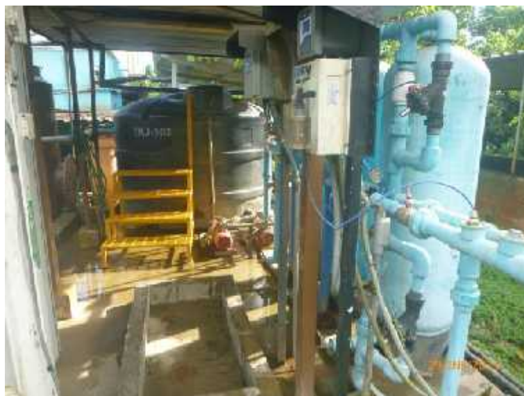
Fotografía 8: Sistema de dosificación de cloro a efluente en PTARD C1 en CBM (Fuente: PPC)
