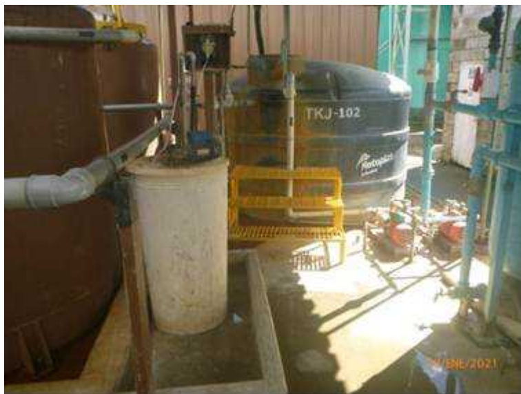
Fotografía 16: Sistema de dosificación de cloro a efluente en PTARD C4 en CBM (Fuente: PPC)
