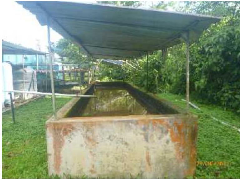
Fotografía 6: Cámara de secado con lodos activos manejados como residuos en PTARD C1 en CBM (Fuente: PPC)
