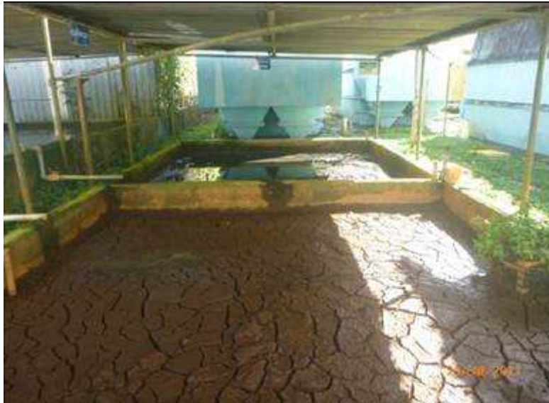
Fotografía 14: Cámara de secado con lodos activos manejados como residuos en PTARD C4 en CBM (Fuente: PPC)
