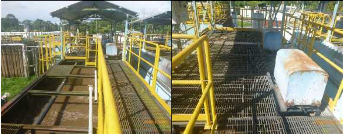
Fotografía 13: Aguas residuales domésticas en tratamiento y aireadores en Cámara de Aireación, y dosificador de cal de PTARD C4 en CBM (Fuente: PPC)
