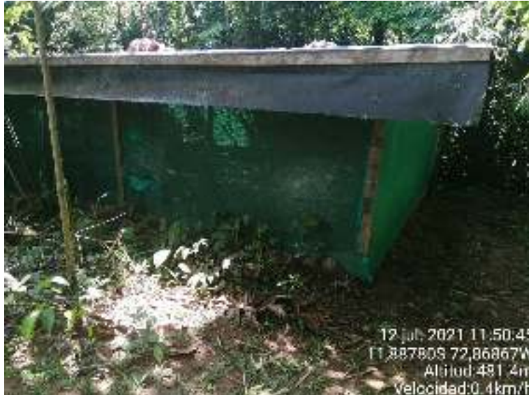
Fotografía 10: Vista externa de la fosa de residuos biodegradables en CV 17+500 (Fuente: PPC)
