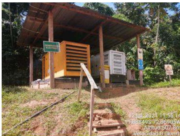
Fotografía 13: Generadores eléctricos, con KIT antiderrame y extintor en CV 17+500 (Fuente: PPC)
