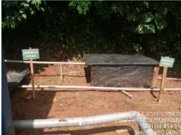
Fotografía 14: Trampas de grasa y espuma para el tratamiento de aguas residuales (Fuente: PPC)
