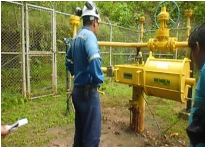
En esta imagen se aprecia que el operador de la planta, explicando el detalle del incidente.
