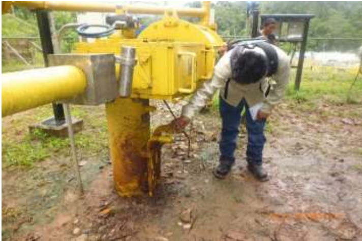
Monitor Didier Choronto señalando el punto donde se produjo la emisión de gas de la Línea de Conducción Mipaya a Malvinas.
