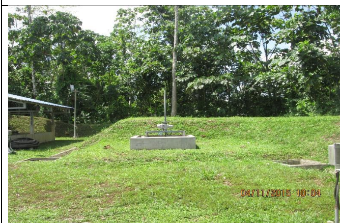
En esta otra imagen se observa la bomba automática que ayuda a la descarga del agua limpia de hidrocarburo al río Urubamba.
