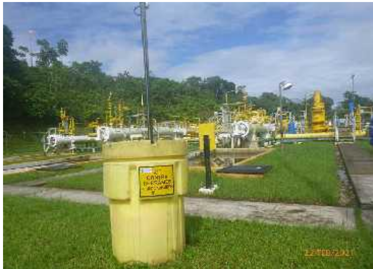
Fotografía 8: Kit contra derrames en área de llaves Manifold en Pagoreni A (Fuente: PPC)
