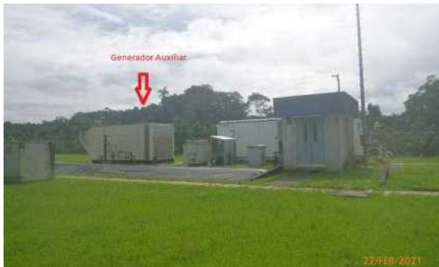
Fotografía 23: Grupo electrógeno auxiliar a gas en Locación Pagoreni A (Fuente: PPC)
