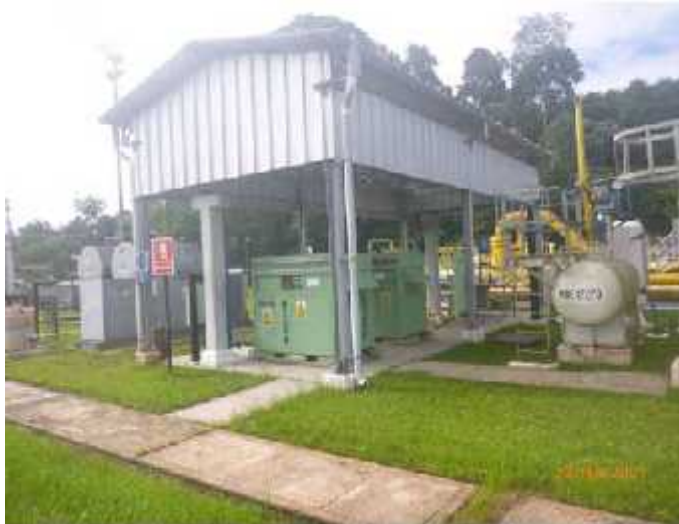
Fotografía 9: Sistema de aire de instrumentos y servicios, compresores y tanques, en Pagoreni A (Fuente: PPC)
