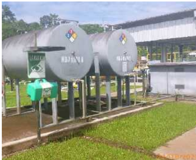
Fotografía 10: Sistema de inyección de inhibidor de corrosión, tanques en Pagoreni A (Fuente: PPC)
