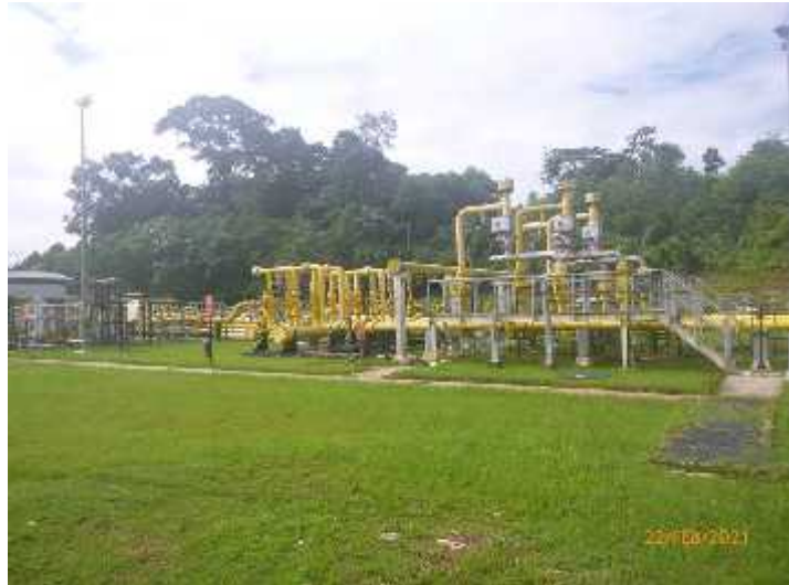
Fotografía 7: Vista panorámica del área de llaves Manifold en Locación Pagoreni A (Fuente: PPC)
