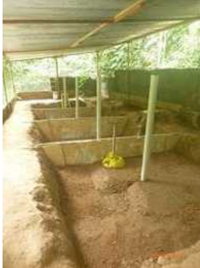
Fotografía 22: Vista interna de la fosa biodegradable en Locación Pagoreni A (Fuente: PPC)
