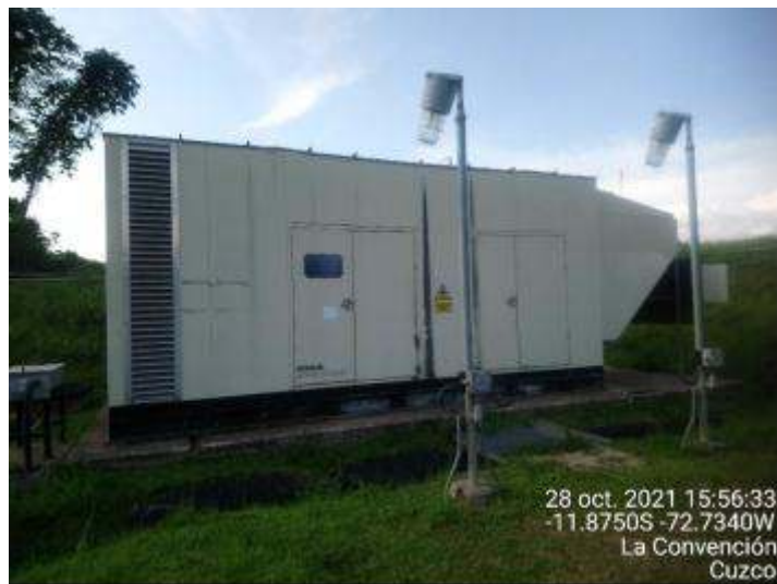
Fotografía 32: Generador marca WAUKESHA en Locación Cashiriari 1 (Fuente: PPC)
