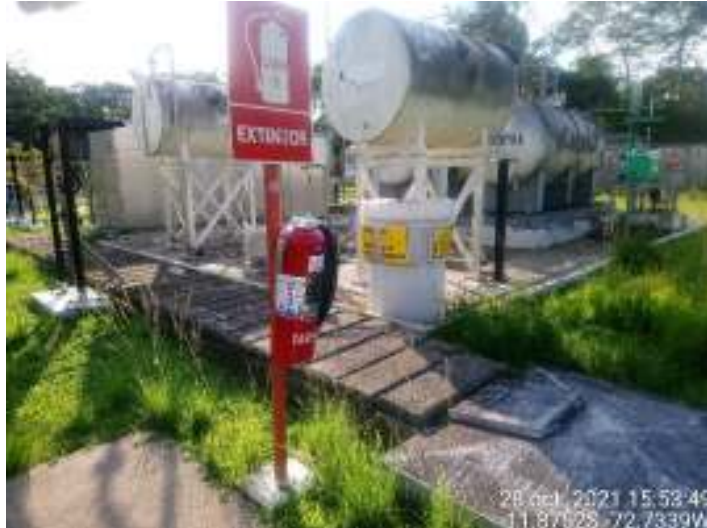
Fotografía 13: Sistema de inyección con bombas de inhibidor de corrosión y kit preventivo de incendios y derrame, en área de servicios auxiliares, en Cashiriari 1 (Fuente: PPC)
