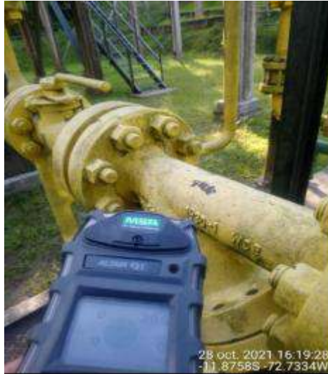
Fotografía 18: Medición del LEL en el área del KOD en Cashiriari 1 (Fuente: PPC)
