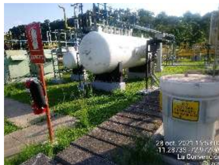
Fotografía 12: Zona de tanques de almacenamiento de aire de servicios e instrumentos en Cashiriari 1 (Fuente: PPC)
