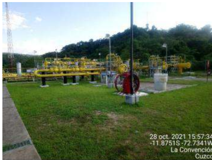
Fotografía 9: Zona de lanzaderas con kit antiderrame y pits de contención de fugas (Fuente: PPC)
