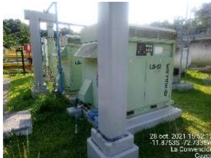
Fotografía 11: Zona de generación de aire con cabezales de compresión en Cashiriari 1 (Fuente: PPC)
