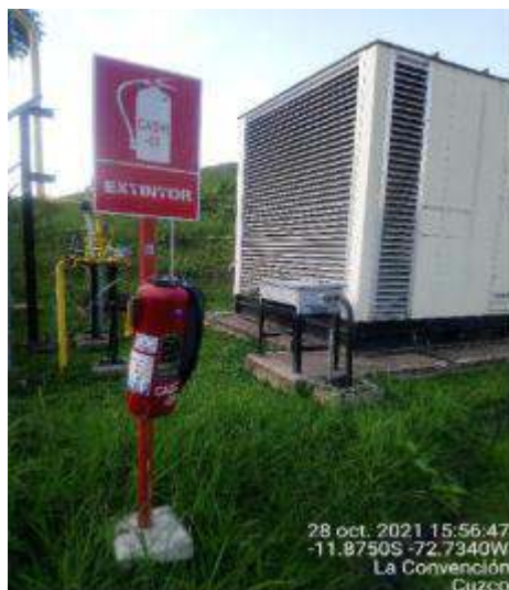
Fotografía 33: Extintor vigente en área de generador en Locación Cashiriari 1 (Fuente: PPC)
