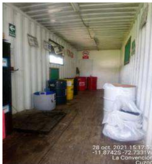
Fotografía 21: Vista interna del almacén temporal de residuos en Locación Cashiriari 1 (Fuente: PPC)
