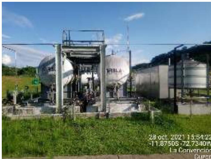
Fotografía 14: Sistema de inyección con tanques de almacenamiento de inhibidor de corrosión en Cashiriari 1 (Fuente: PPC)
