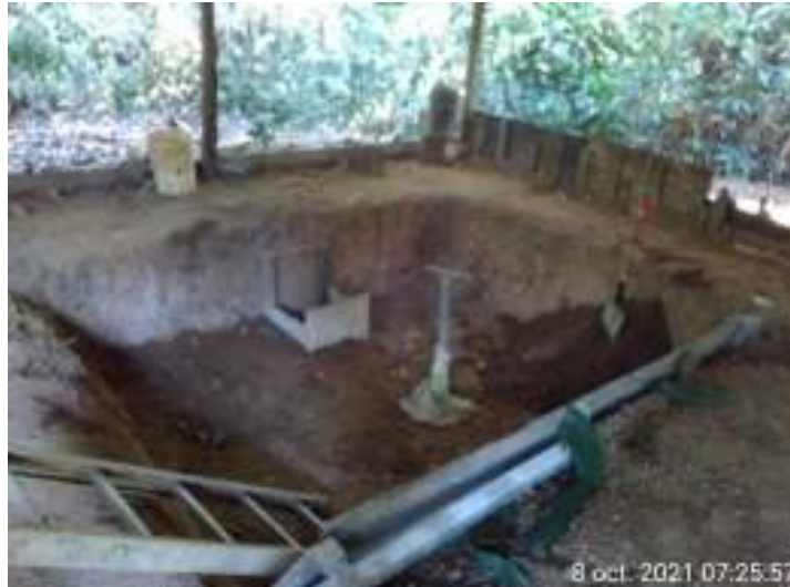
Fotografía 31: Vista interna de celda en la fosa biodegradable de Locación Cashiriari 1 (Fuente: PPC)
