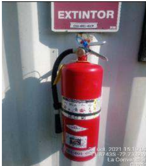
Fotografía 22: Extintor vigente del almacén temporal de residuos en Locación Cashiriari 1 (Fuente: PPC)
