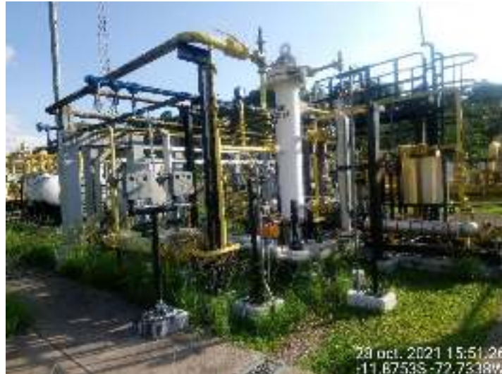
Fotografía 10: Sistema de fuel gas en Cashiriari 1 (Fuente: PPC)
