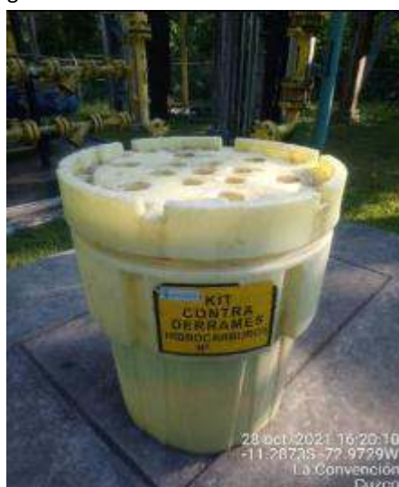
Fotografía 17: Kit contra derrame de productos químicos en el área del KOD en Cashiriari 1 (Fuente: PPC)
