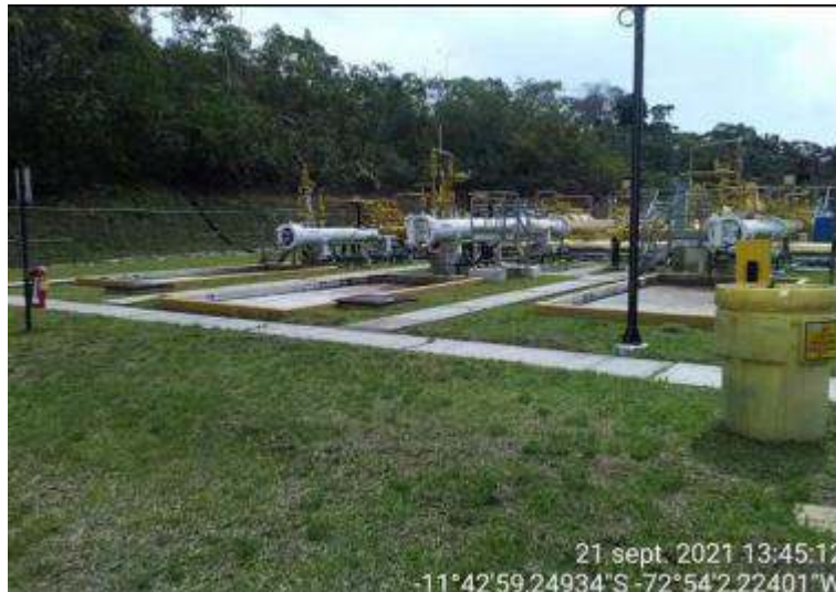
Fotografía 9: Zona de lanzaderas con kit antiderrame y pits de contención de fugas en área de llaves Manifold en Pagoreni A (Fuente: PPC)
