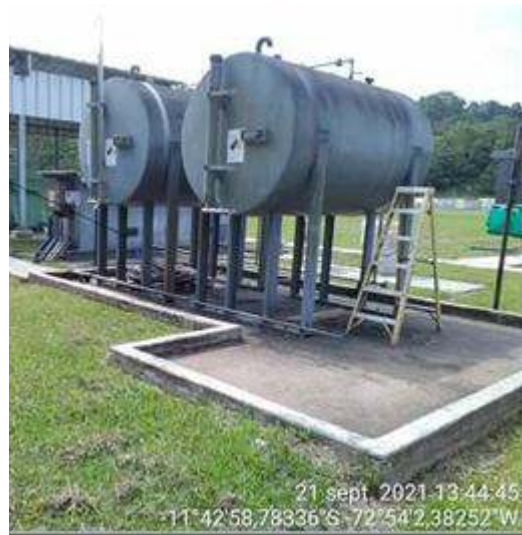
Fotografía 14: Sistema de inyección con tanques de almacenamiento de inhibidor de corrosión en Pagoreni A (Fuente: PPC)
