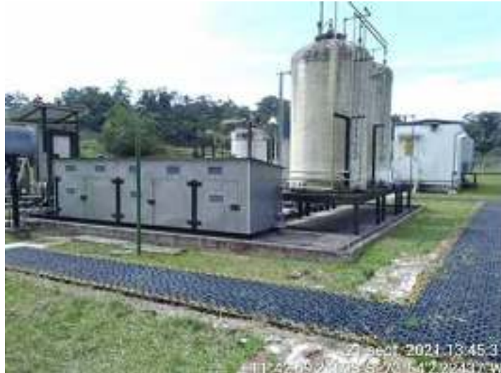
Fotografía 13: Sistema de inyección con bombas de inhibidor de corrosión en Pagoreni A (Fuente: PPC)
