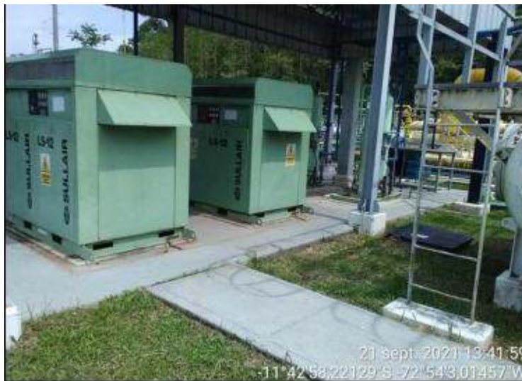
Fotografía 11: Zona de generación de aire con cabezales de compresión en Pagoreni A (Fuente: PPC)
