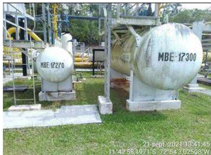
Fotografía 12: Zona de tanques de almacenamiento de aire de servicios e instrumentos en Pagoreni A (Fuente: PPC)
