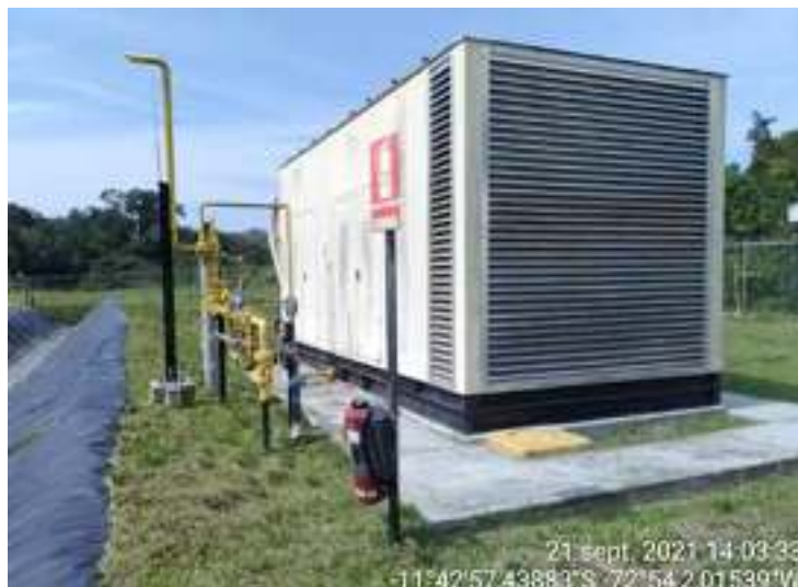
Fotografía 40: Generador marca WAUKESHA en Locación Pagoreni A (Fuente: PPC)
