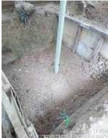
Fotografía 39: Vista interna de celda en la fosa biodegradable de Locación Pagoreni A (Fuente: PPC)
