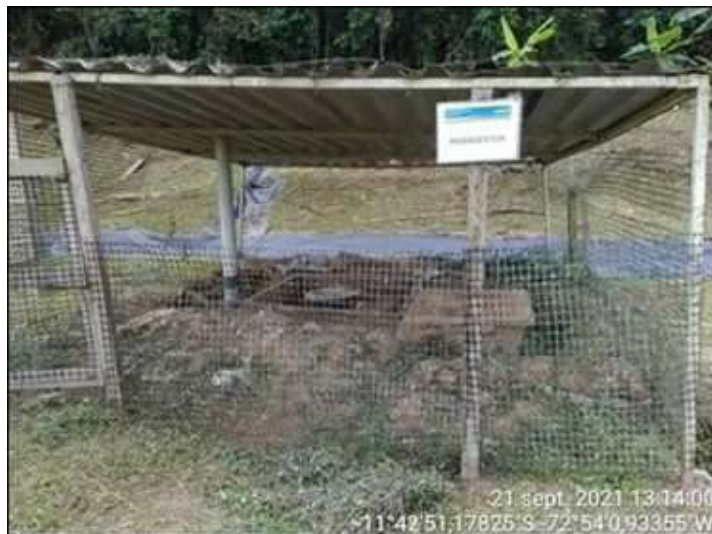
Fotografía 36: Biodigestor en Locación Pagoreni A (Fuente: PPC)
