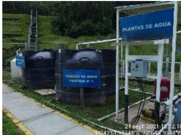
Fotografía 35: Planta de agua potable en Locación Pagoreni A (Fuente: PPC)
