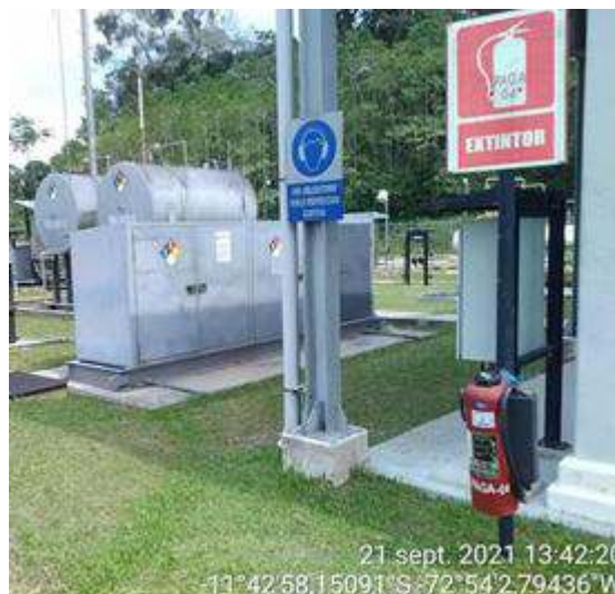
Fotografía 15: Extintor en área de servicios auxiliares en Locación Pagoreni A (Fuente: PPC)
