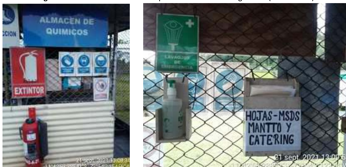
Fotografía 34: Señalética, extintor y hojas MSDS en almacén de sustancias químicas en Locación Pagoreni A (Fuente: PPC)
