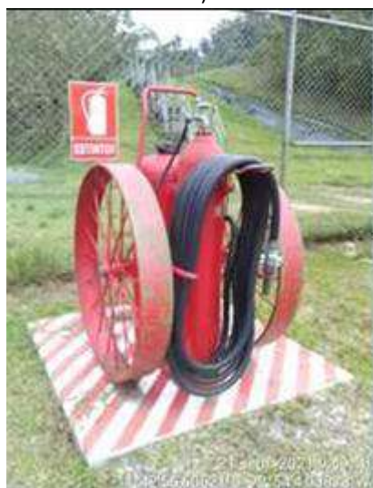
Fotografía 32: Extinguidor del pit de combustibles en Locación Pagoreni A en Malvinas (Fuente: PPC)
