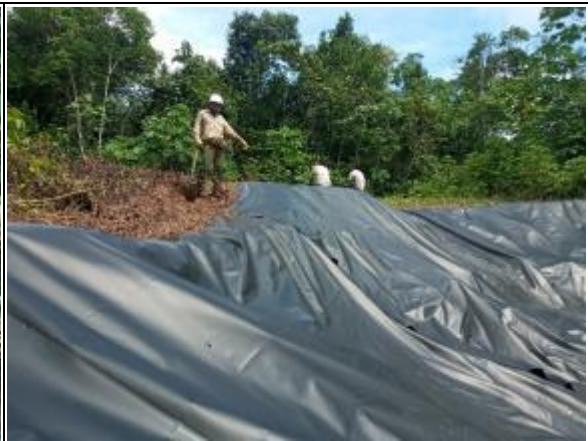
En el sitio de la PK 29+580, se muestra el control temporal de erosión y deslizamiento en el DdV, mediante la puesta de una geomembrana.
